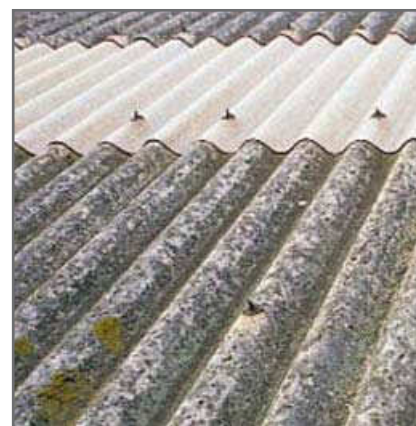
Placas de fibrocemento con amianto
